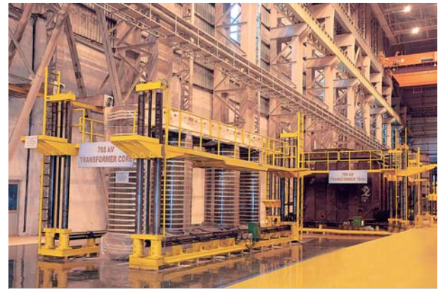
बीएचईएल, भोपाल में यूएचवीटी ब्लॉक में विनिर्मित 765 केवी ट्रांसफार्मर
