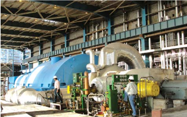
बीएचईएल द्वारा चालू किया गया 490 मेगावाट टीजी सेट (यूनिट-5) एनसीटीपीपी चरण-II, दादरी
