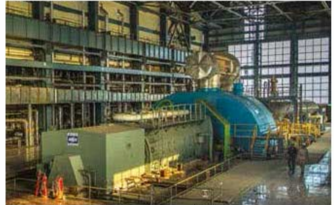
बेलगारी एमटीबीएस, कर्नाटक में 700 मेगावाट सुपरक्रिटिकल यूनिट का टरबाइन हॉल
