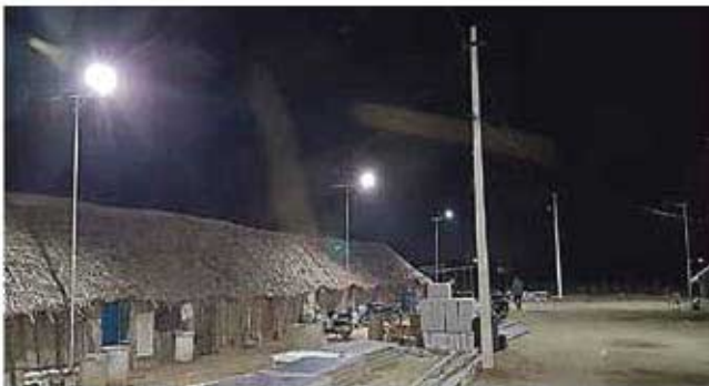
मेडक गांव, तेलंगाना में बीएचईएल द्वारा लगाई गई सोलर स्ट्रीट लाइट
